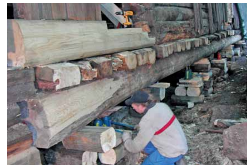
Her trengs gammel håndverkskunnskap! Fra rehabilitering av en gammel sjøbod i Drammen. Foto: Stokk & Stein
